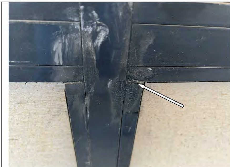
Фото №43. Зазор в стыке металлических профилей оконного блока на балконе.
