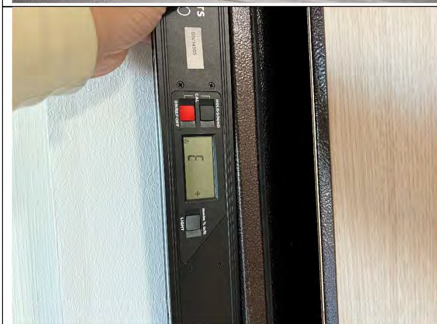
Фото № 53. Отклонение коробки от плоскостности и прямолинейности входного дверного блока на 3 мм.
