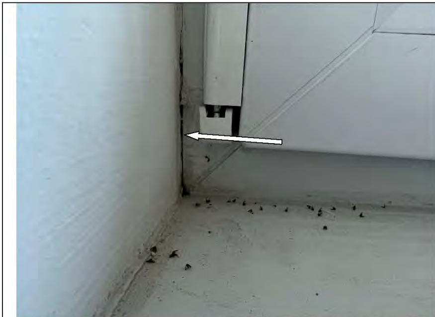
Фото №28. Щель между рамой конного блока ПВХ и откосом в кухне.
