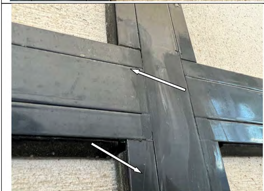
Фото №41. Царапина на металлическом профиле оконного блока на балконе.
