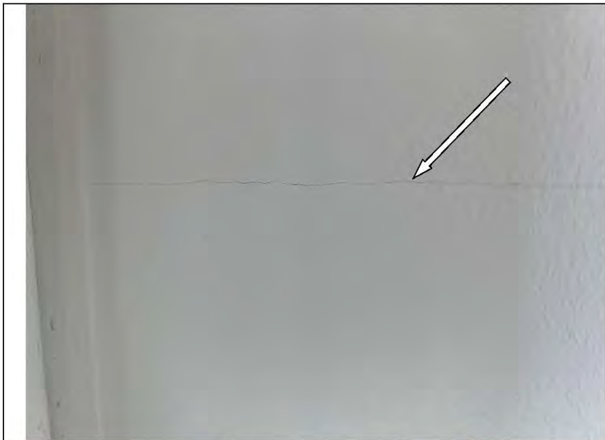
Фото №37. Трещина на откосе оконного блока ПВХ в кухне.
