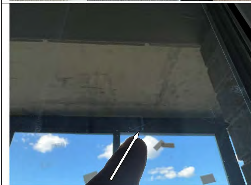
Фото №39. Царапина на стеклопакете оконного блока ПВХ в спальне.
