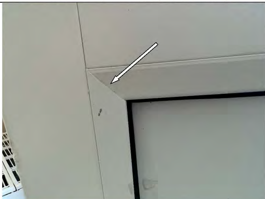
Фото №47. Зазор в стыке профилей ПВХ оконного блока в спальне.
