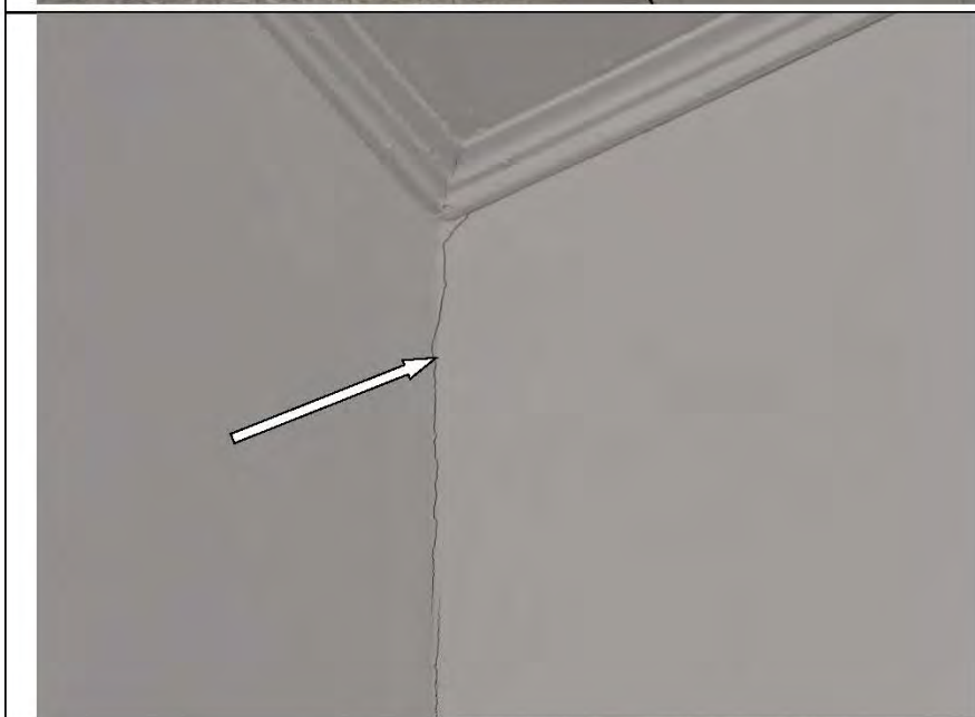
Фото №20. Трещина по стене в ванной комнате.
