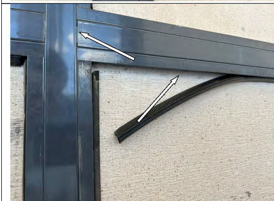
Фото №44. Зазор в стыке металлических профилей оконного блока на балконе. Отслоение уплотнительной ленты от металлического профиля оконного блока на балконе.
