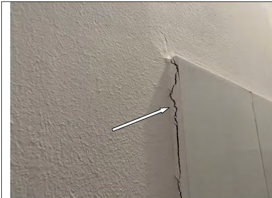
Фото №19. Отслоение настенной керамической плитки в ванной комнате.
