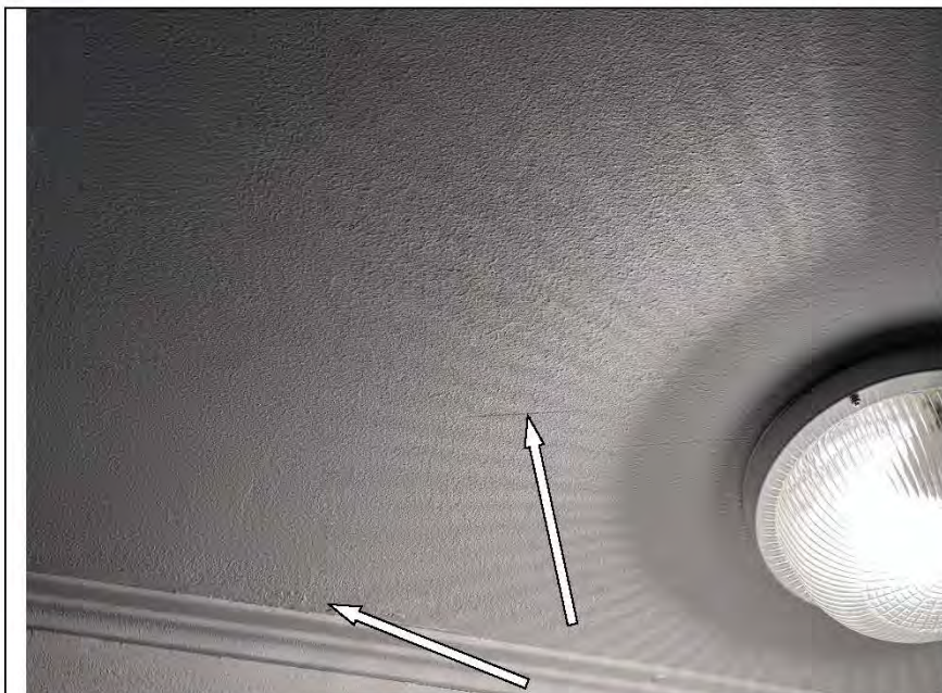
Фото № 52. Подтеки краски на потолке в ванной комнате.
