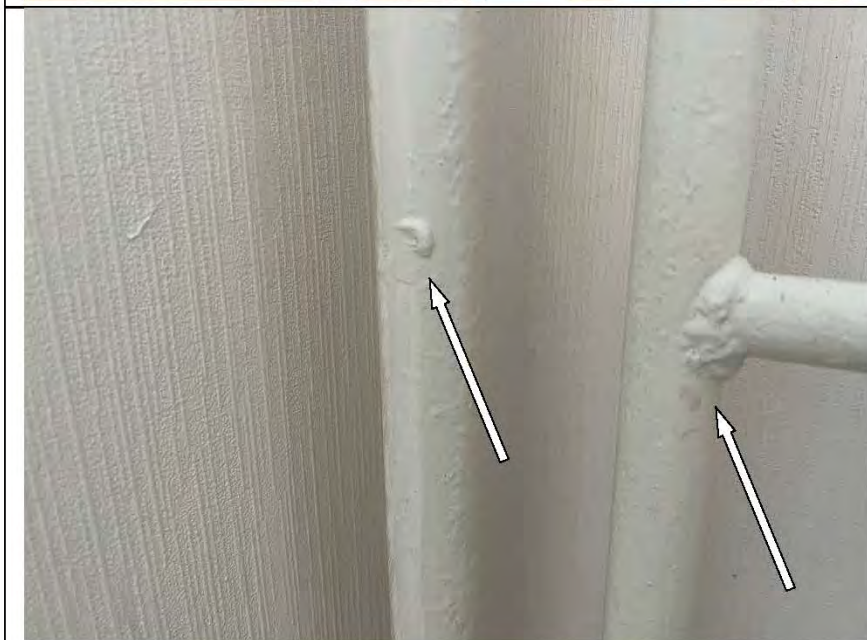
Фото № 62. Подтеки краски на трубах отопления в кухне.
