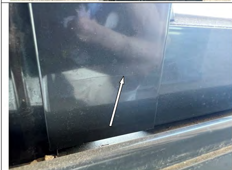
Фото №42. Царапина на металлическом профиле оконного блока на балконе.
