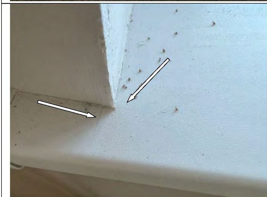
Фото №32. Царапина на лицевой поверхности подоконной доски в кухне.
