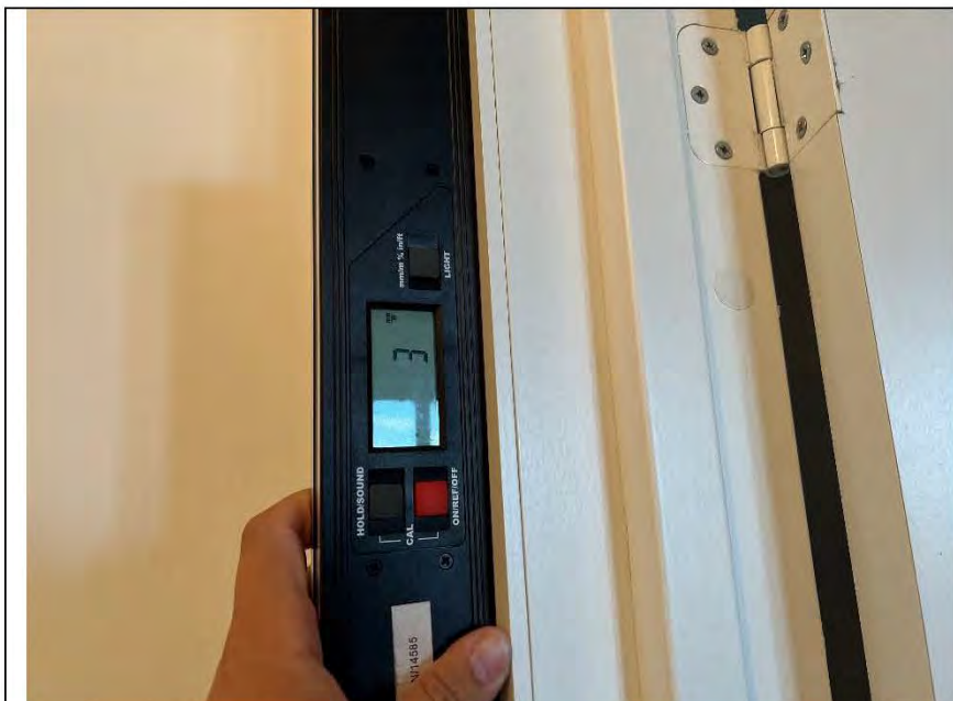
Фото № 61. Отклонение наличников дверного блока в ванной комнате на 3 мм.
