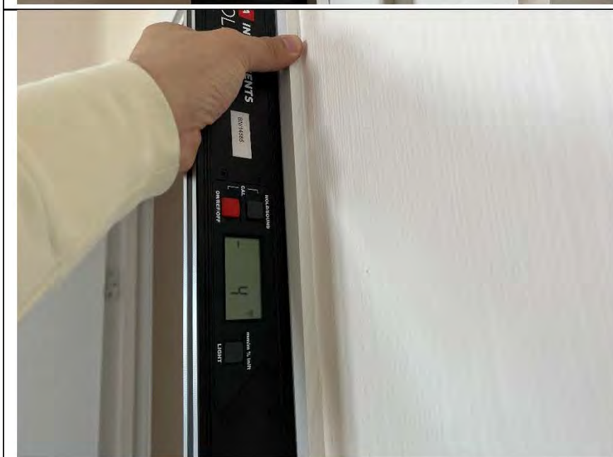
Фото № 60. Отклонение наличников дверного блока в кухне на 4 мм.
