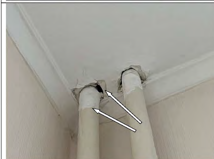
Фото №50. Отслоение покрасочного слоя на потолке в спальне. Подтеки краски на трубах отопления в спальне.
