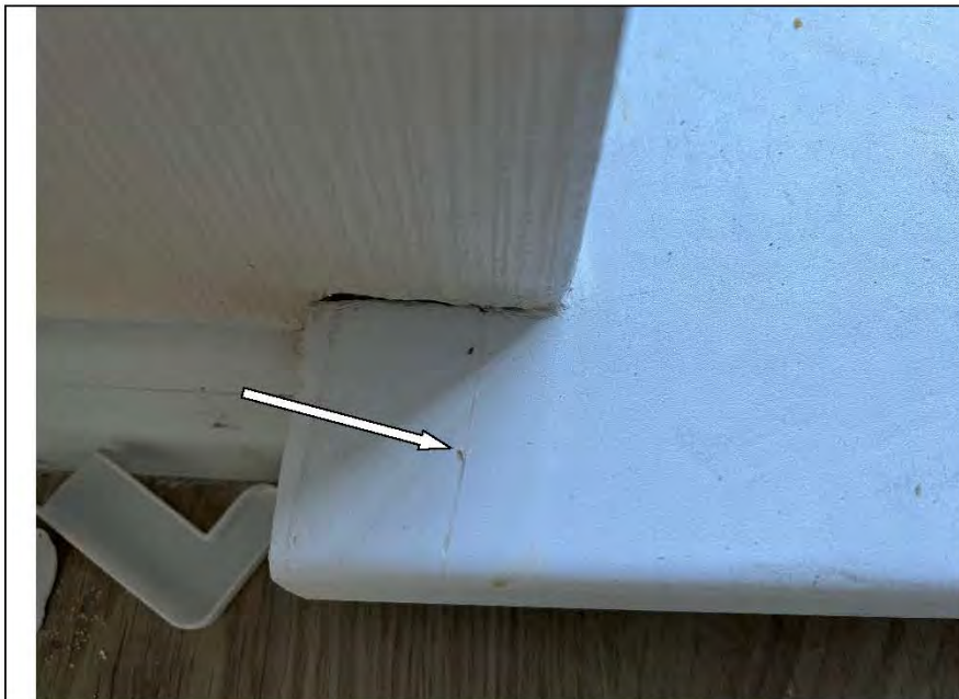
Фото №31. Царапина на лицевой поверхности подоконной доски в спальне.
