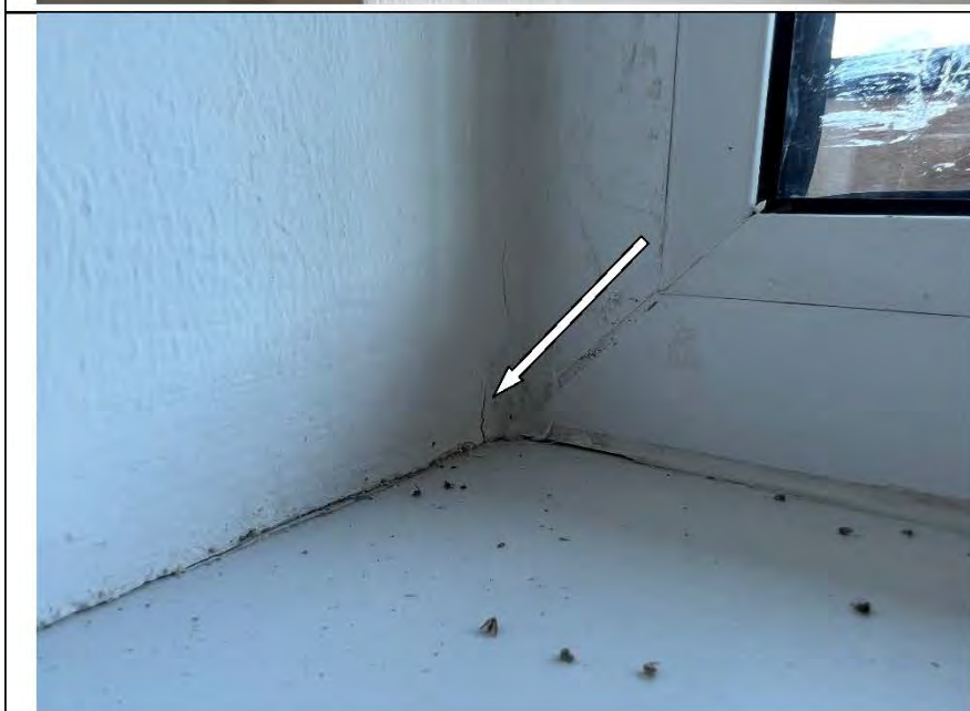
Фото №35. Трещина на откосе оконного блока ПВХ в спальне.
