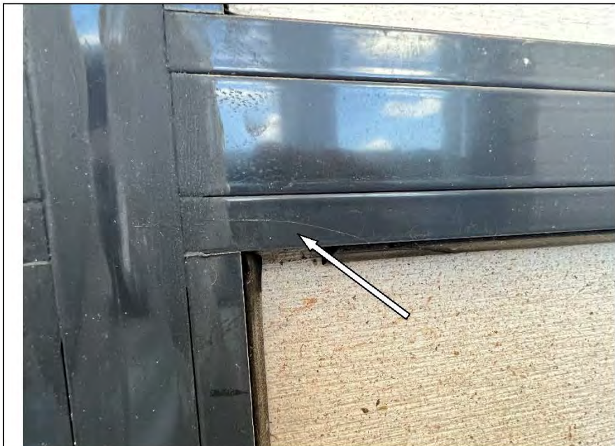
Фото №40. Царапина на металлическом профиле оконного блока на балконе.
