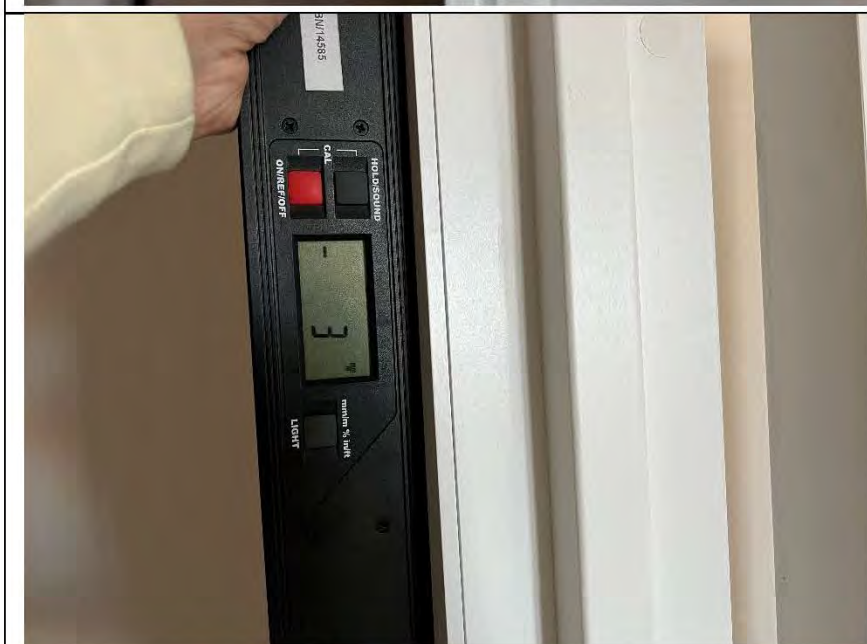
Фото № 59. Отклонение наличников дверного блока в спальне на 3 мм.
