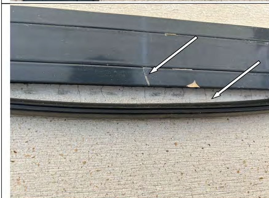
Фото №45. Царапина на металлическом профиле оконного блока на балконе. Отслоение уплотнительной ленты от металлического профиля оконного блока на балконе.
