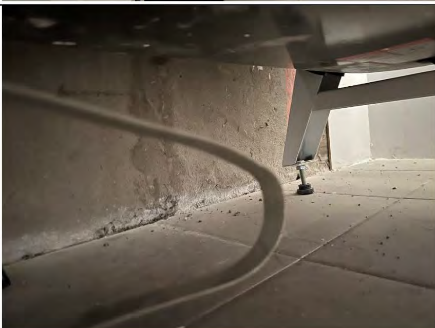
Фото №18. Частично отсутствует настенная керамическая плитка за ванной.
