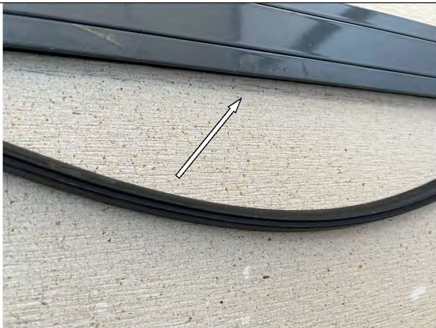
Фото №46. Отслоение уплотнительной ленты от металлического профиля оконного блока на балконе.
