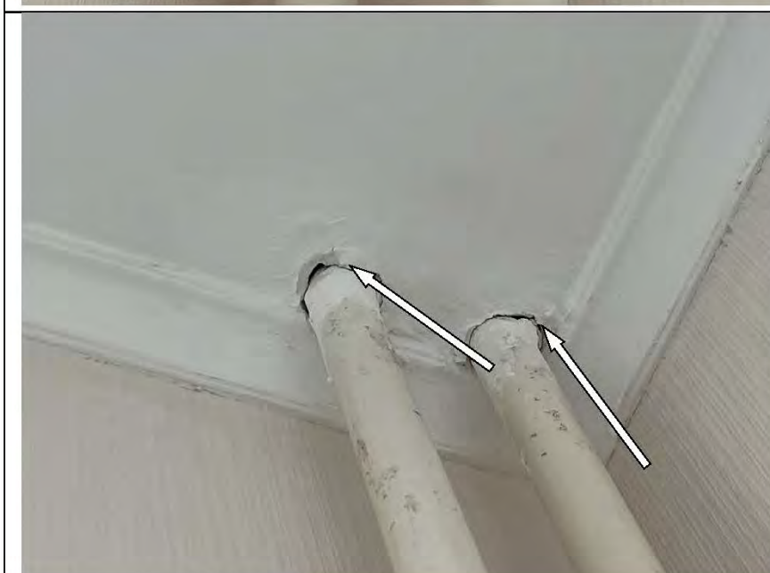
Фото №51. Отслоение покрасочного слоя на потолке в кухне.
